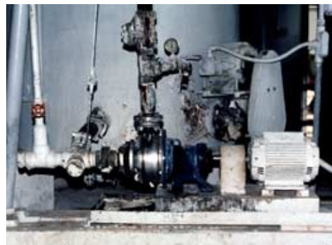
Boiler feed, Alimentación de caldera
